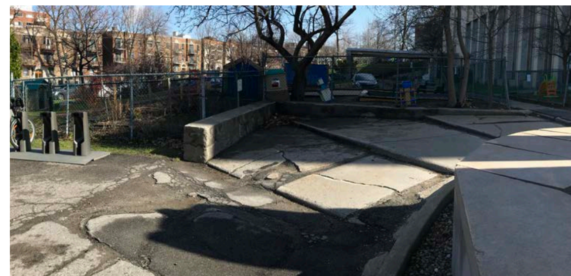
SURFACE DE BÉTON DÉGRADÉE! PARVIS DU PAVILLON J. A. DESÈVE
