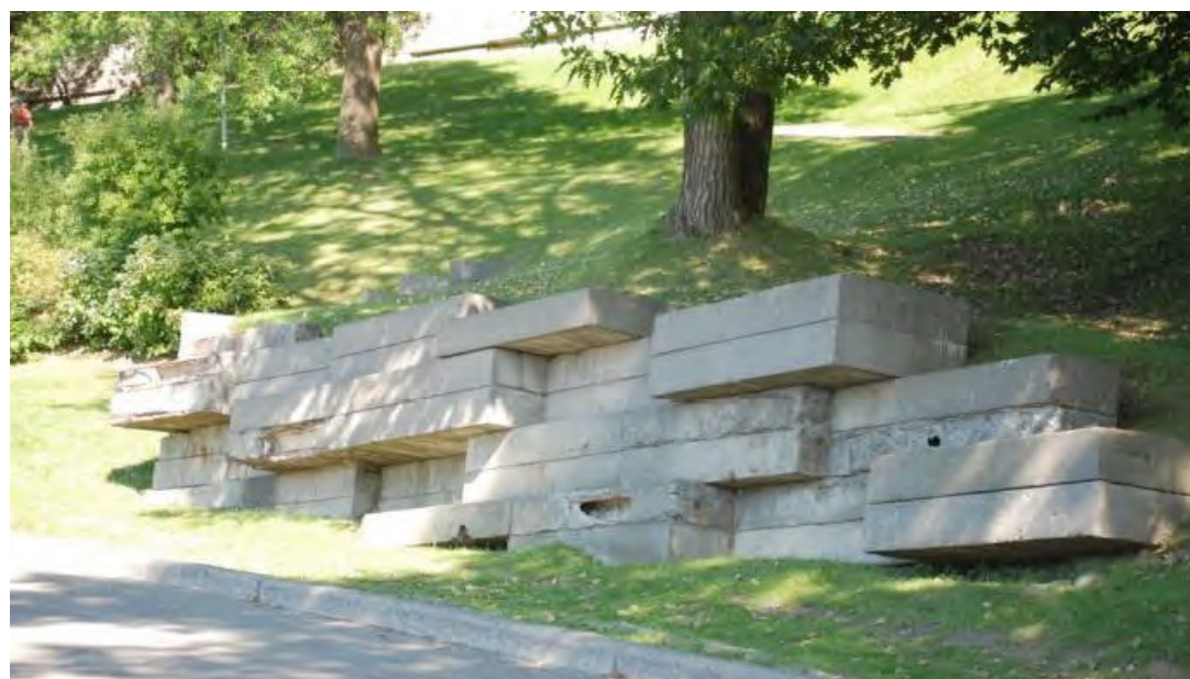
MUR DE SOUTÈNEMENT CARACTÉRISTIQUE | CHEMIN DE LA RAMPE (SOURCE - MARIO BRODEUR CONSULTANT, 2012)
