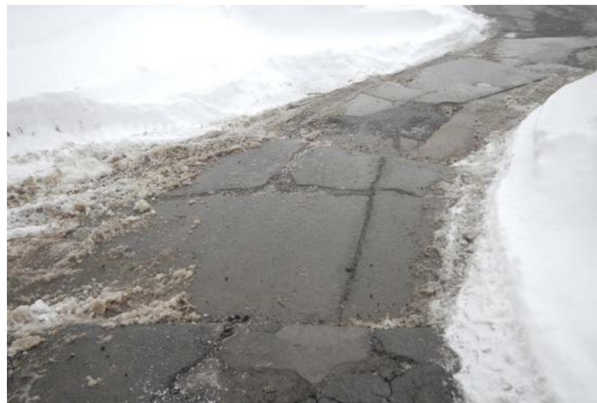
ZONE D'UN RÉSEAU PIÉTONNIER, EN MAUVAIS ÉTAT (LA MULTIPLICATION DE CREVASSES NE PERMET PAS DE DISTINGUER LA PRÉSENCE D'UNE MARCHE)
