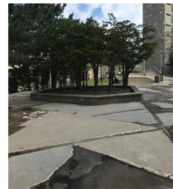
SURFACE DE BÉTON DÉGRADÉE! RÉSIDENCES
