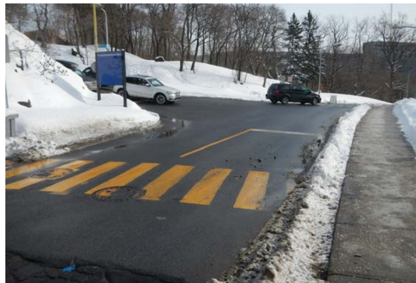
ENTRETIEN DÉFICIENT DES PASSAGES PIÉTONNIERS (LA PRÉSENCE DE NEIGE EN BORDURE DE TROTTOIR OBSTRUE LE PASSAGE AUX PERSONNES À MOBILITÉ RÉDUITE)
