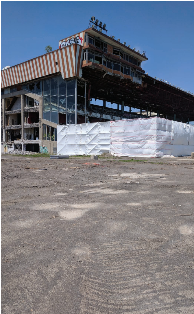
Démolition des bâtiments sur le site de l'ancien hippodrome, première étape de sa mise en valeur, 2018
