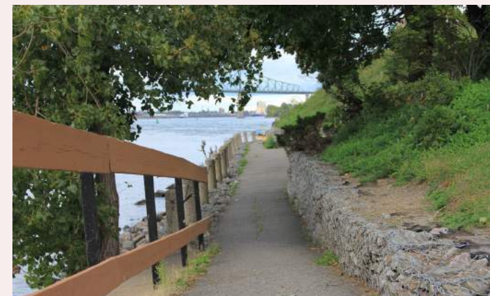
Sentier qui permet un rapprochement avec l'eau, mais dont les ouvrages de soutènement s'affaissent, 2019, Ariane Malo-Sauvé.
