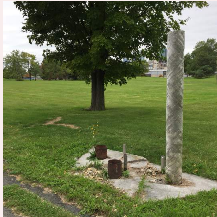
Vestiges des lampadaires conceptualisés par les architectes Frank Macioge et Luis F. Villa, 2019, Guillaume Archambault-Lelièvre.
