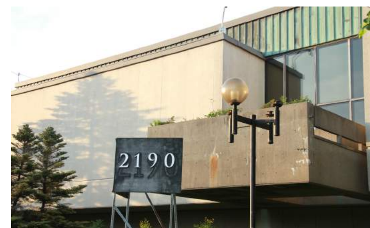
Un des balcons du Musée d'art, qui présente des signes de dégradation évidents, 2019, Ariane Malo-Sauvé.
