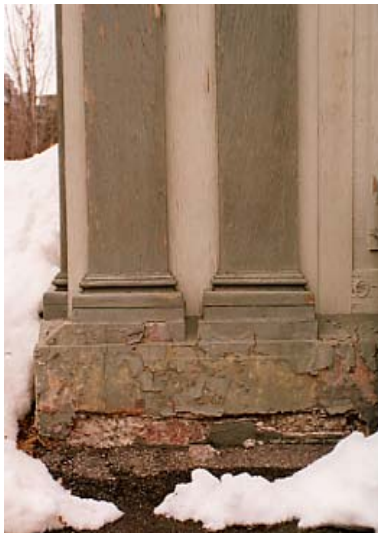
Figure 63 - Problème d'effritement de l'auberge
