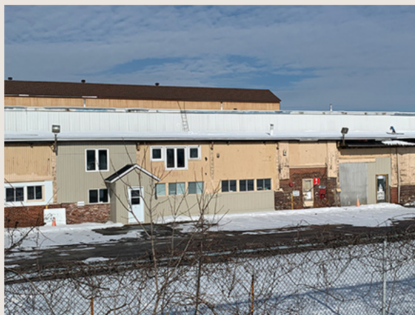
▲ Figure 79. Les bureaux de la Cintube ( Dominion Bridge Sud ) autrefois la « Welding and test Lab and Maintenance storage area » (105 a) sont affublés de différents revêtements métalliques.
