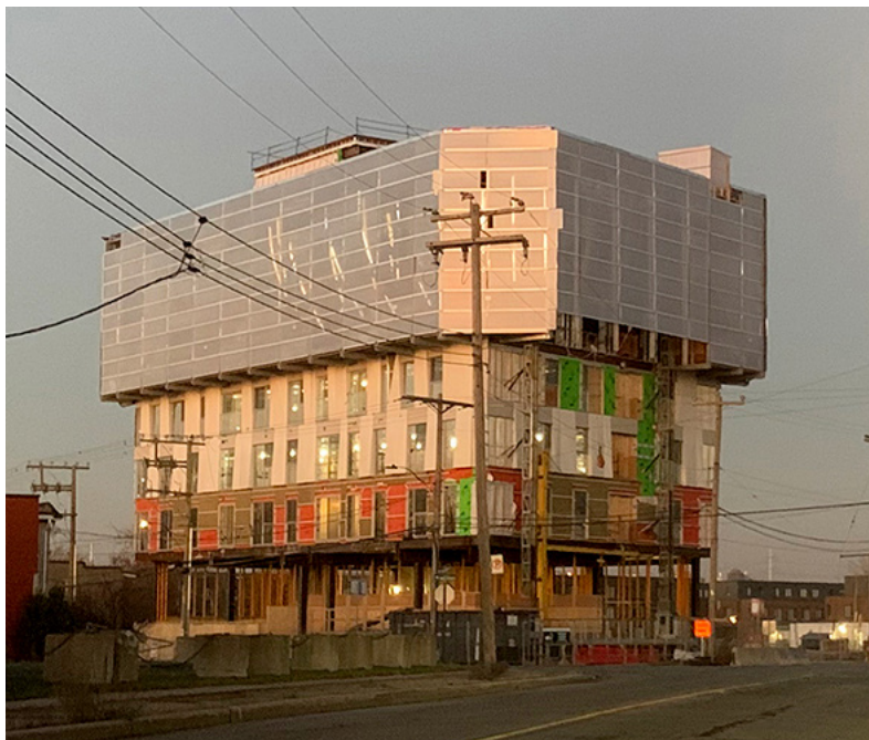
▲ Figure 91. Exemple d'une tour résidentielle en cours de construction sur le site.
