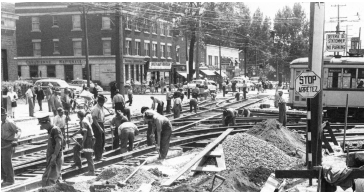
Installation des rails de tramway à l'intersection des rues Décarie et Queen-Mary (tiré de la collection Pignon sur rue : Notre-Dame-de-Grâce )
